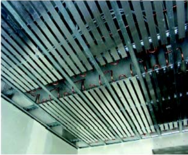
Chladiaci strop neoplášťovaný
